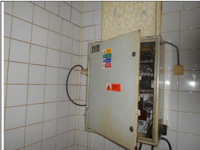
Pohľad na elektrickú skriňu
