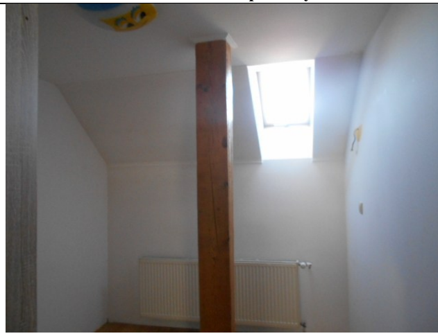
Pohľad na radiátor + okno v podkroví
