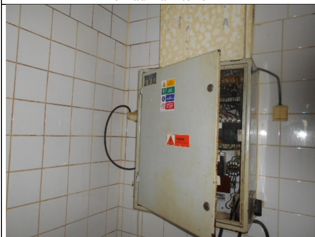
Pohľad na elektrickú skriňu
