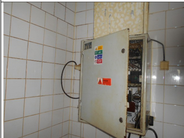
Pohľad na elektrickú skriňu
